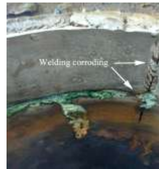
图 1 反应器的腐蚀情况
