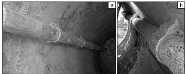
图 5 循环 6 炉次后排氯化镁管的照片
